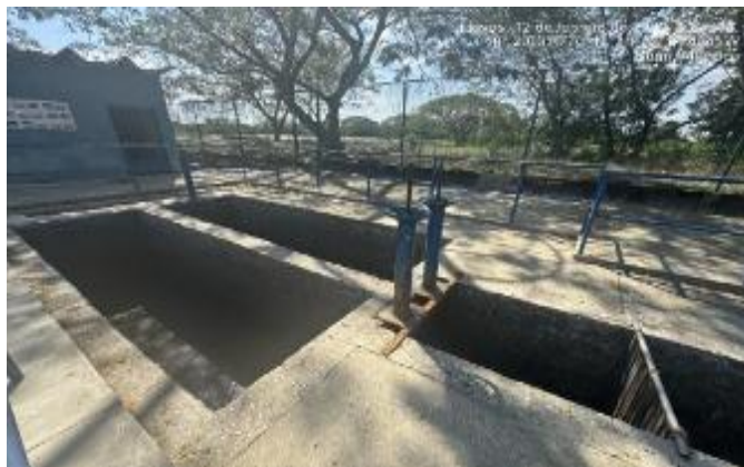
Imagen 39. Registro fotográfico Desarenador Acueducto y Alcantarillado Municipal de Suan - AAMUS S.A.
