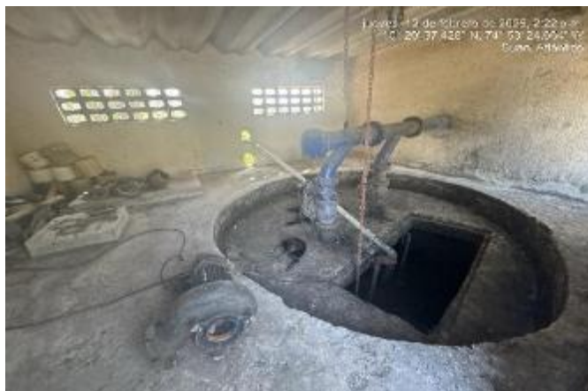
Imagen 40. Registro fotográfico Estación de Bombeo Acueducto y Alcantarillado Municipal de Suan - AAMUS S.A.
