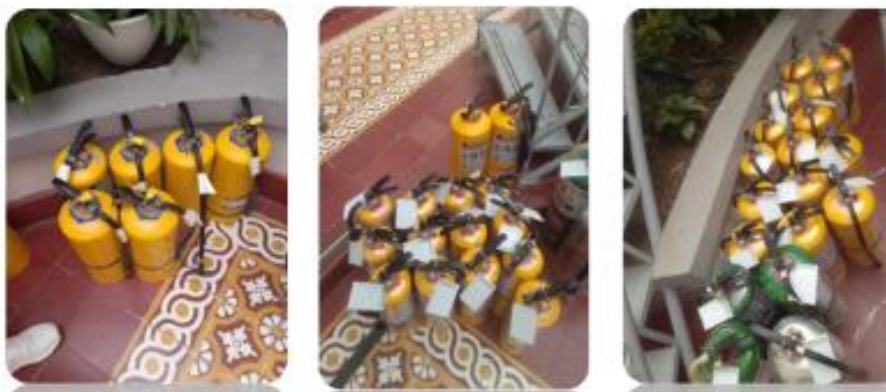
Imagen 119. Mantenimiento preventivo y correctivo a extintores de la C.R.A.
