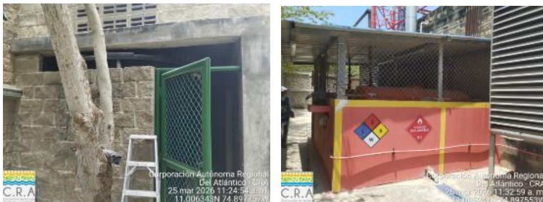
Imagen 70. Sistema de almacenamiento de combustible Biodiesel (2 tanques 1000 gal).
